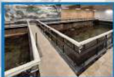
Captare apă brută Izvarna, Gorj
